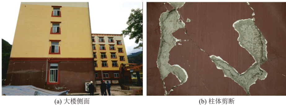
图9 王岗坪乡政府大楼损坏特征
