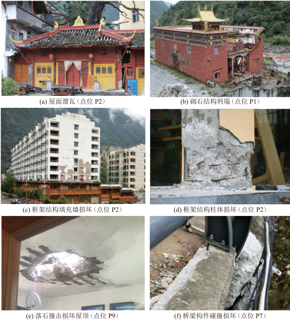
图 7 震中区主要结构损坏形式
